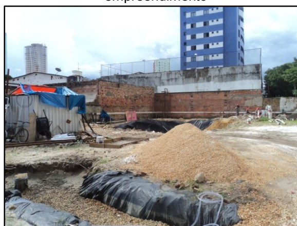
Foto 6 – Vista interna da instalação do empreendimento
