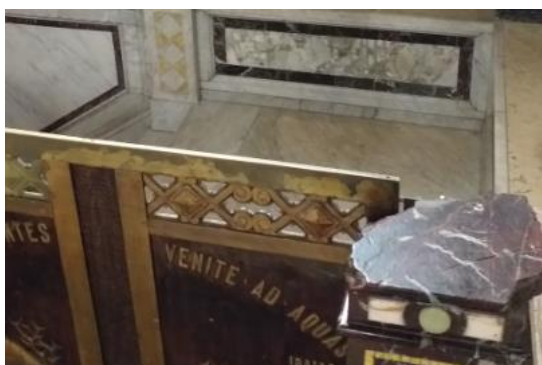
Figura 67: Mureta da cripta danificada
